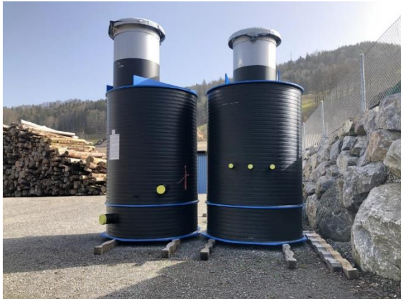
Bild: Brunnenstuben Farnbodenstrasse und Sammelschacht Chellentobel, der schwarze Teil liegt später im Erdreich
